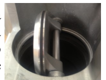
Válvula aberta totalmente
