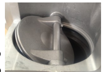
Válvula aberta parcialmente
